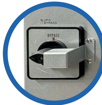
Conmutador de BYPASS de mantenimiento
